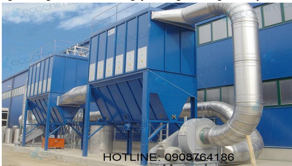
Hình 3.1. Hệ thống lọc túi tại dây chuyền sản xuất gạch không nung
